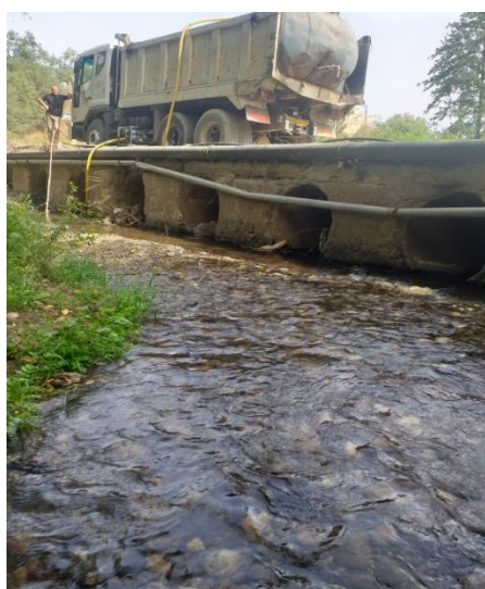
Photo2 : Pompage de l'eau (HAL1).
