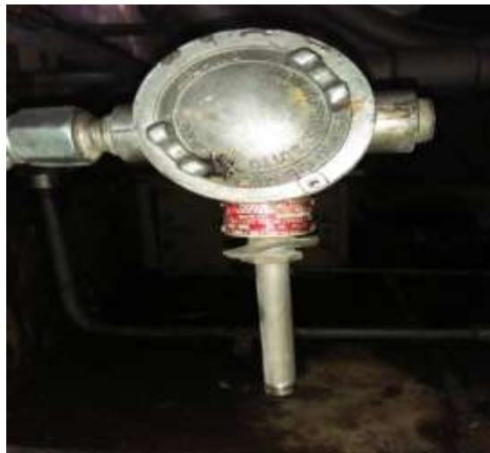
Fig1.17 : Détecteur de chaleur à 163 °C
