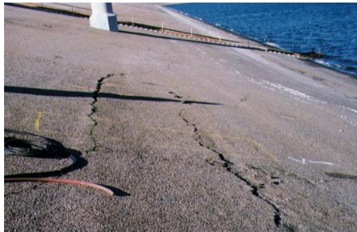
Figure 1.5. Tassement dans le barrage de Los Angeles durant le séisme de Northridge, 1994.
