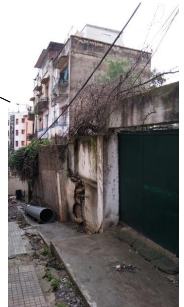
Figure 23 : immeuble d'habitation en mauvaise état. Source : prise par auteurs.
