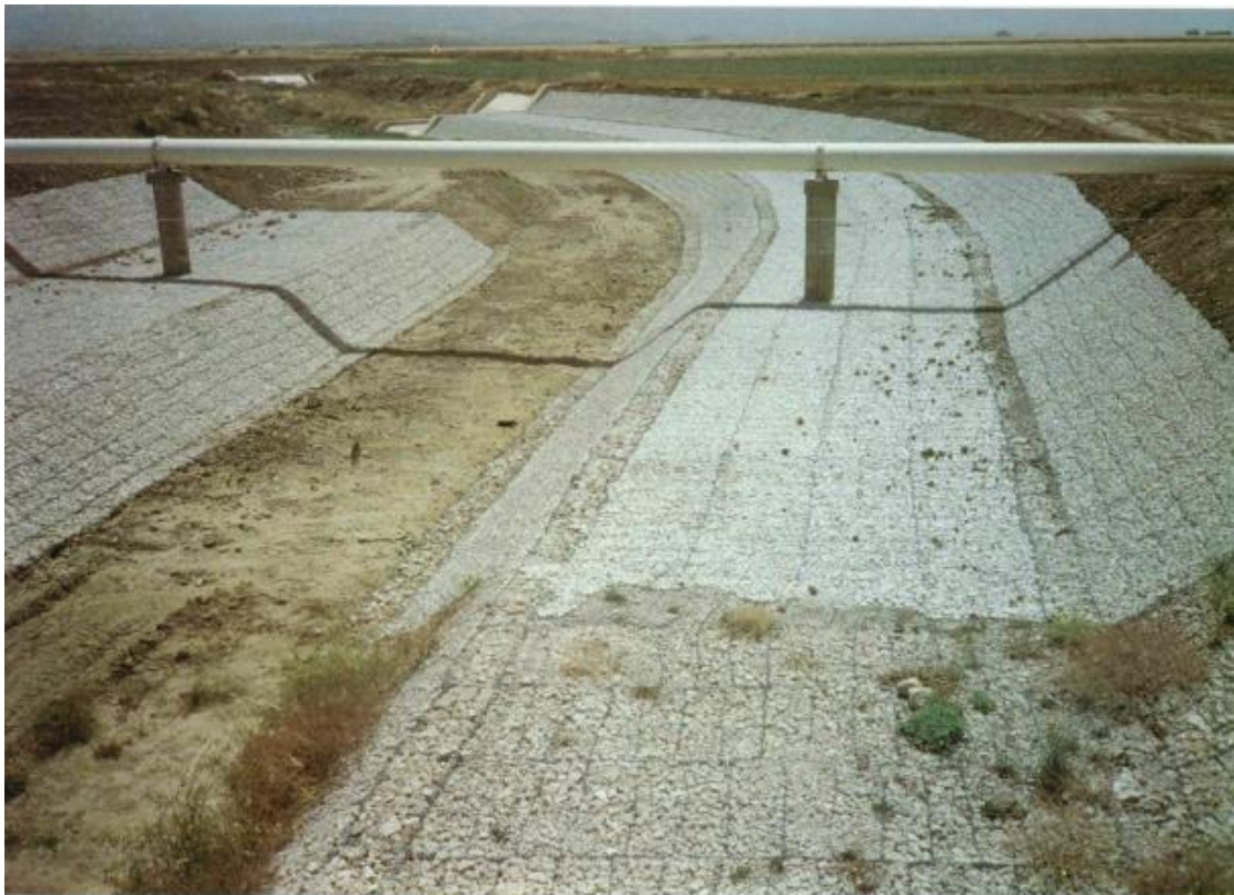
Figure 1.2: revêtement en matelas Reno de la rivière de Maroglio a Caltanisseta, Sicily, Italie 1982 [2]
