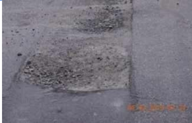
Figure II.5 : Affaissement de chaussée suivi d'une dégradation du revêtement
