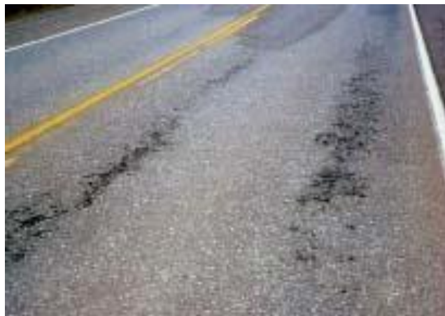
Figure II.10 : Dés enrobage et arrachement dans les couches de chaussées
