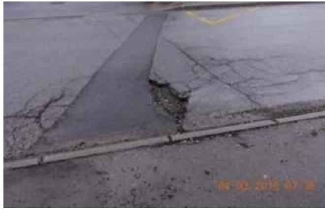
Figure II.7 : décohésion du sol de part et d'autre de la tranchée un faïençage revêtement
