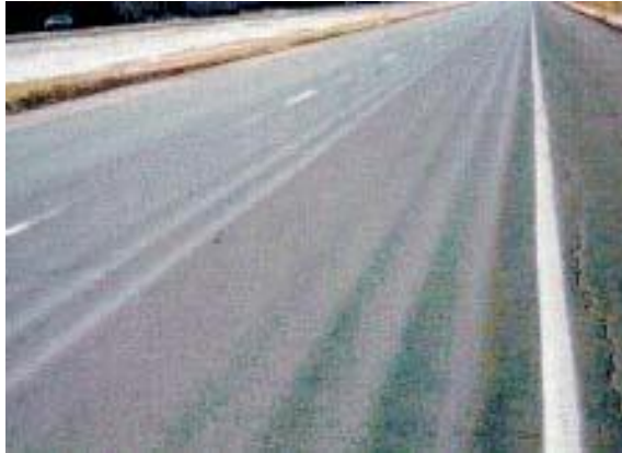
Figure II.8 : Ornière à faible rayon dans les couches de chaussées
