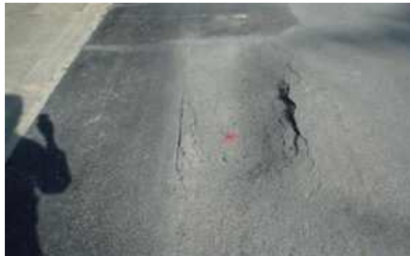
Figure II.4 : affaissement des chaussées
