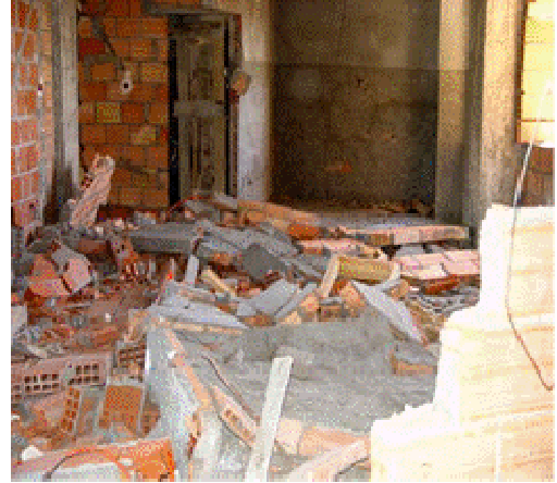
Destruction des panneaux au RdCh
