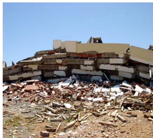
Effondrement total d'un bâtiment de 6 étages
