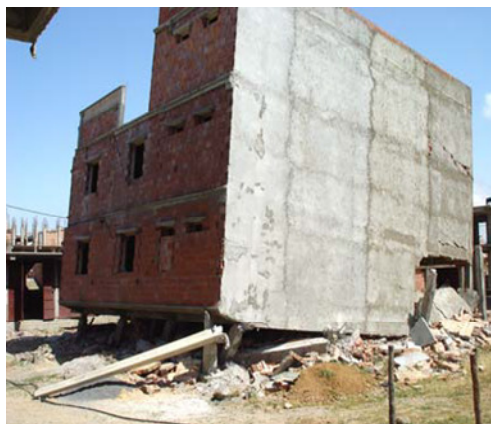
Destruction du RdCh.
