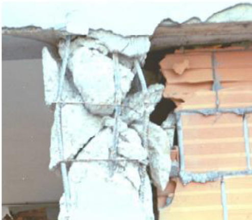
Figure 1. Rupture de poteau par cisaillement (Magenes, 2004)
