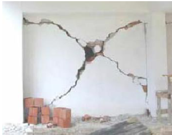
Figure 5. Fissure en X Tremblement de terre d'Izmit, Turquie, 1999 (Omerovic, 2005).
