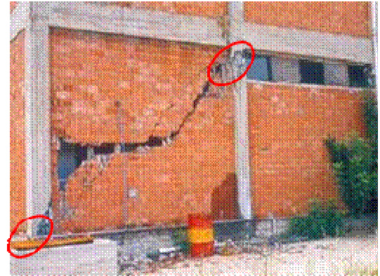
Figure 2. Fissure en diagonale et rupture des poteaux par cisaillement (Apostolska, 2009)
