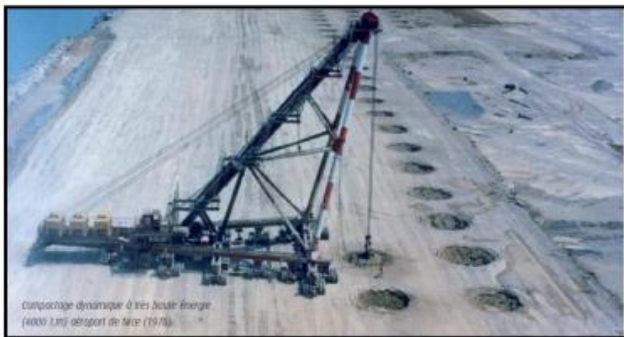
Figure III.2. Densification d'un terrain par compactage dynamique (cas réel de l'aéroport de Nice 1978, France).
