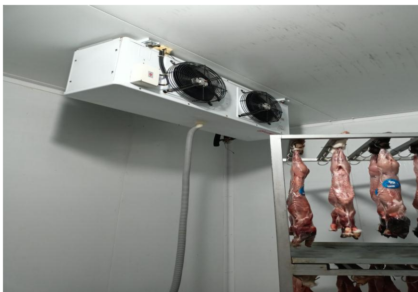
Figure 10 : la chambre de conservation et de stockage.
