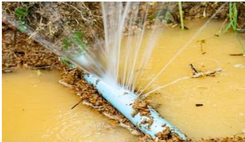
Figure IV.8 : Les effets des coups de bélier peuvent aller jusqu'à l'éclatement des canalisations.
