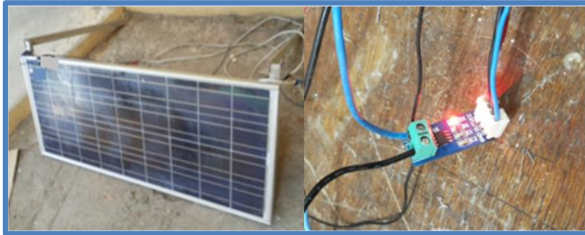
Figure-44 : Acquisition du courant et de la tension du module solaire
