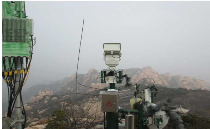
Figure I.14 : Capteur de détection précoce thermique d'incendie de forêt
