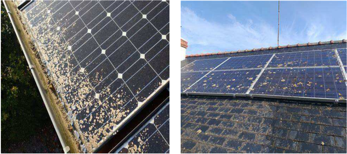
Figure III.1 : défaut de Salissure dans le panneau PV
