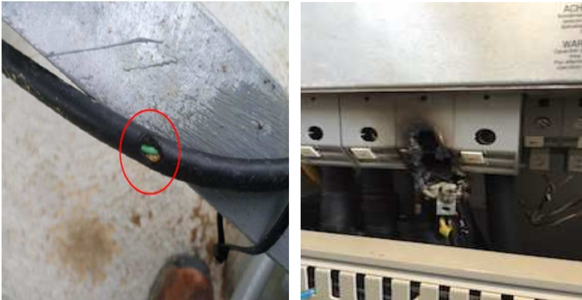
Figure III.6 : quelque défaut dans le système de câblage
