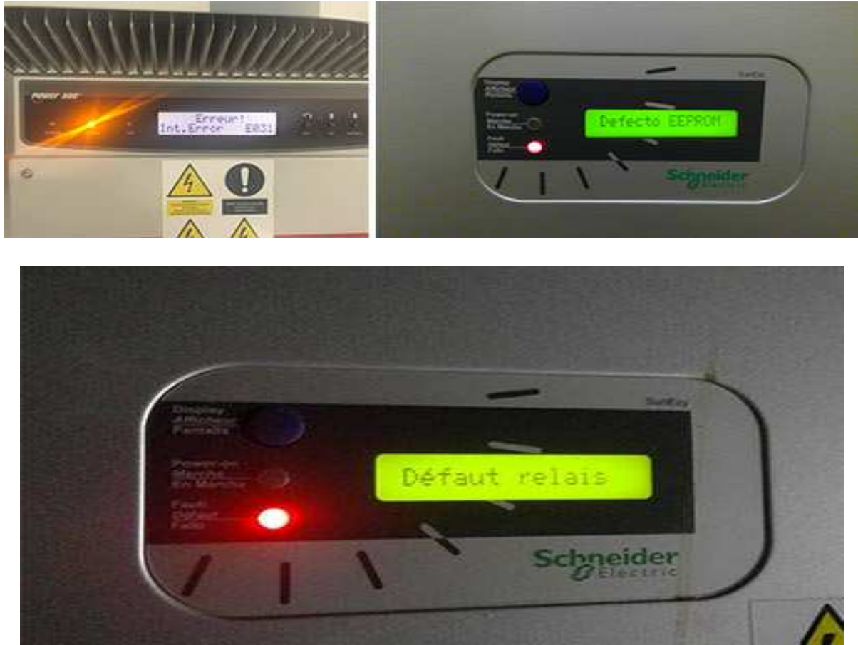
Figure III.5 : quelque défaut de l'onduleur
