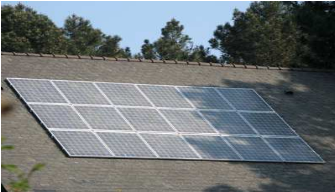
Figure III.3 : défaut d'Ombrage dans le panneau PV
