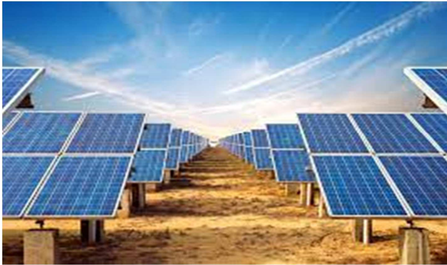
Figure I.6 : panneaux solaire photovoltaïque
