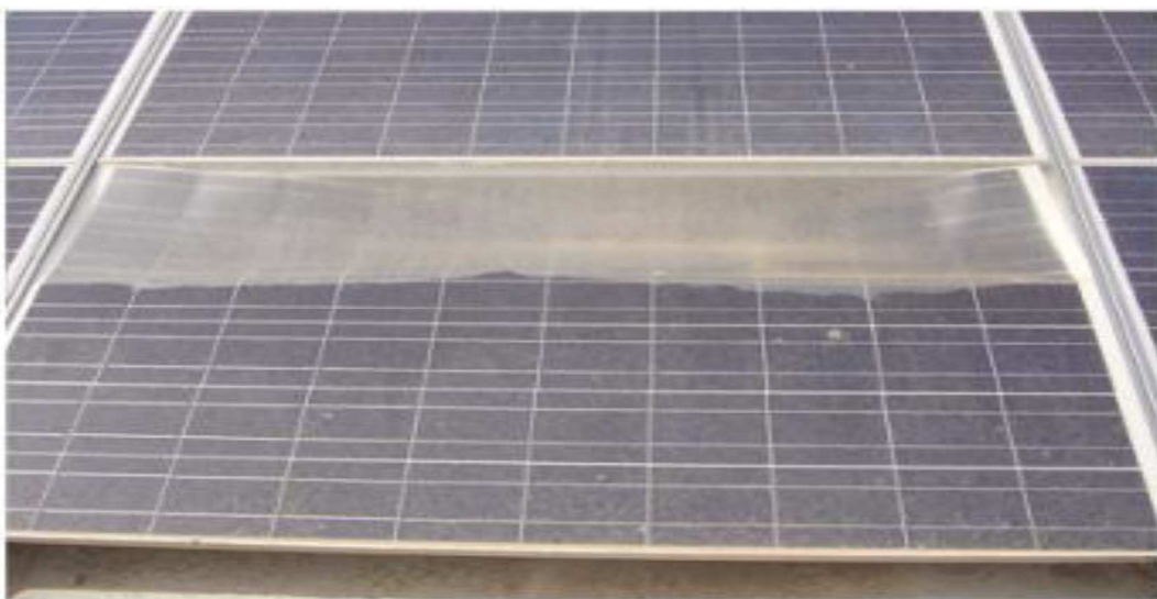
Figure III.4 : défaut de délaminage
