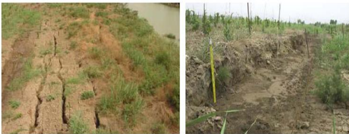
Fissure et déplacement latéral du terrain.
