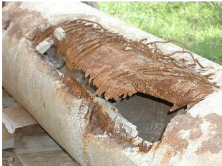
Fig. I. 2. Rupture d'une canalisation survenue suite à la carbonatation des armatures [3]
