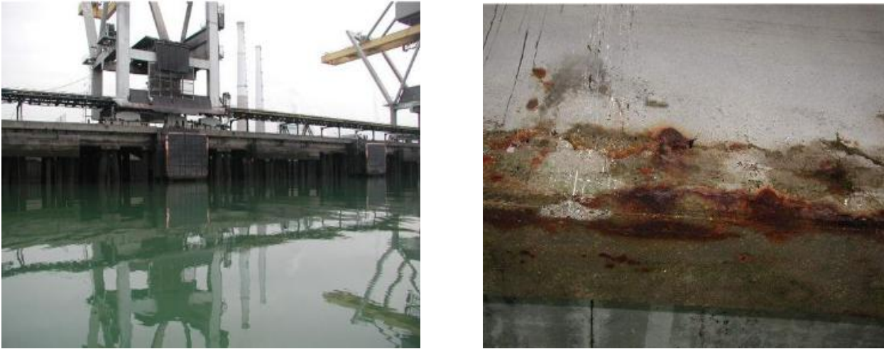
Fig. I.3. Poutre située en bord de mer sous de l'agression des chlorures [3]
