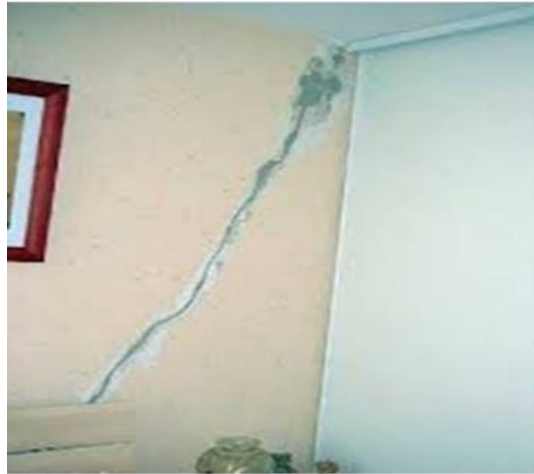
Fig. I.6. Fissure d'un mur en béton [4]
