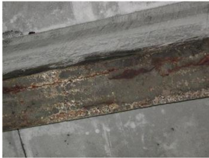
Fig. I.5. Fissuration d'une poutre en béton exposée aux eaux de mer [4]
