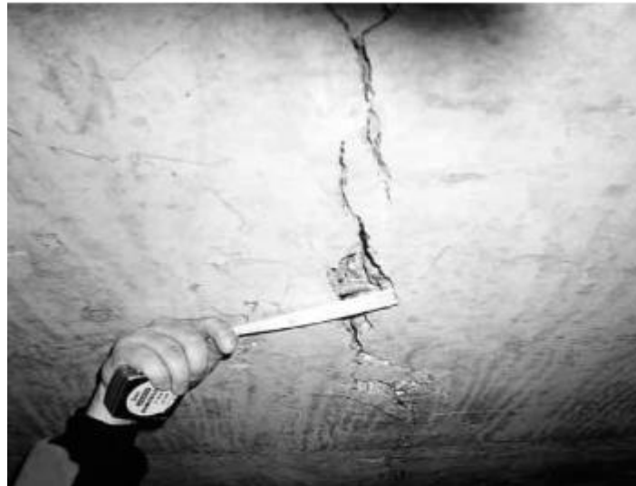
Fig. I. 1. Fracture du tablier sans ruine [2]
