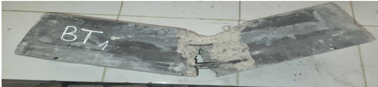
Figure III.13 : Poutre non renforcée endommagée.
