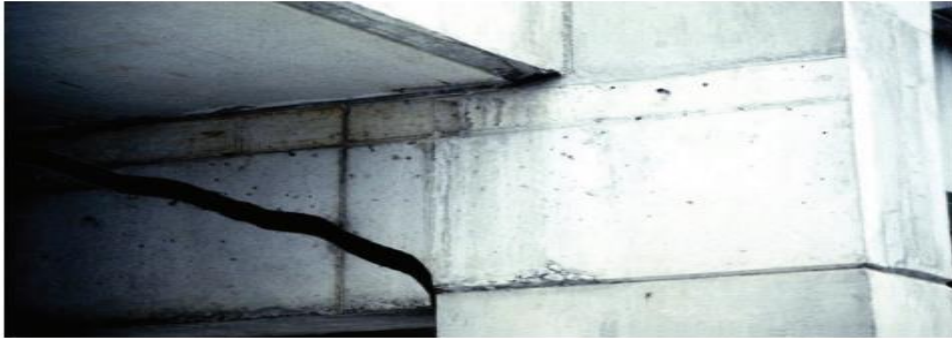
Figure I.3 : Rupture en cisaillement de la poutre [23]
