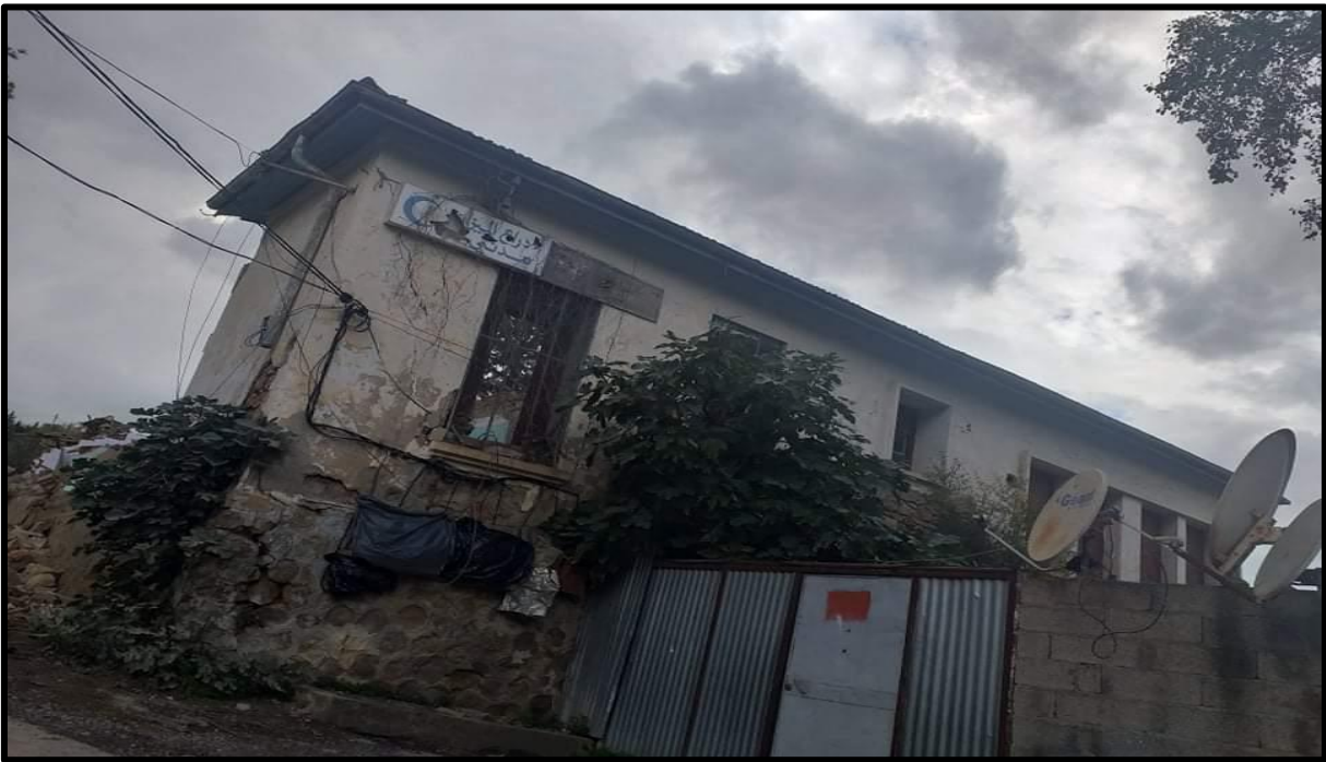
Photo n°12 : La destruction de l'hôpital civil de Dra El Mizan le jeudi 18 novembre 2021.
