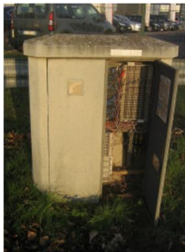
Figure 6 : un sous répartiteur
