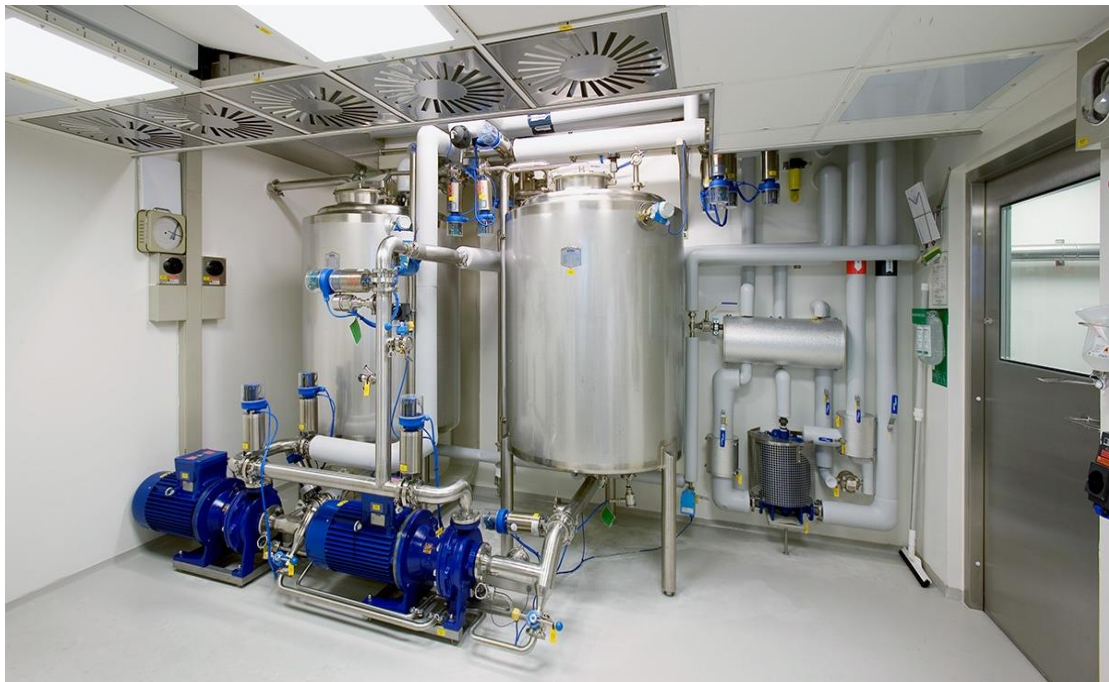
Salle de CIP (nettoyage en place)
