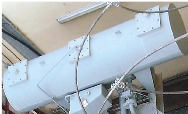
Figure II.12 : Le conservateur d'huile du transformateur
