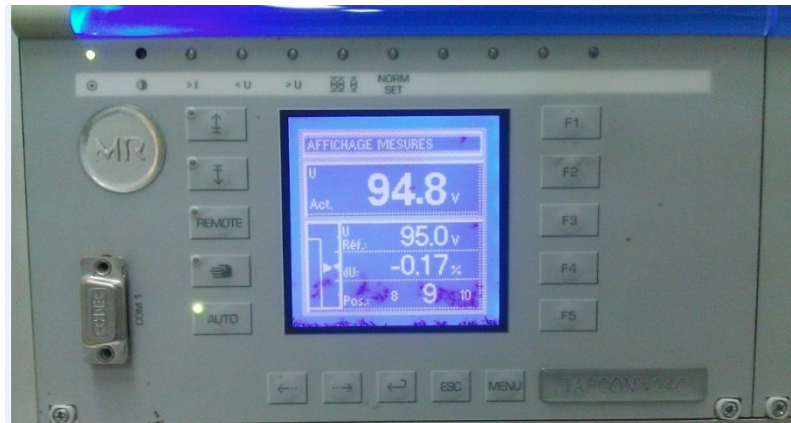
Figure IV.2 : Panneau de commande du régulateur de tension
