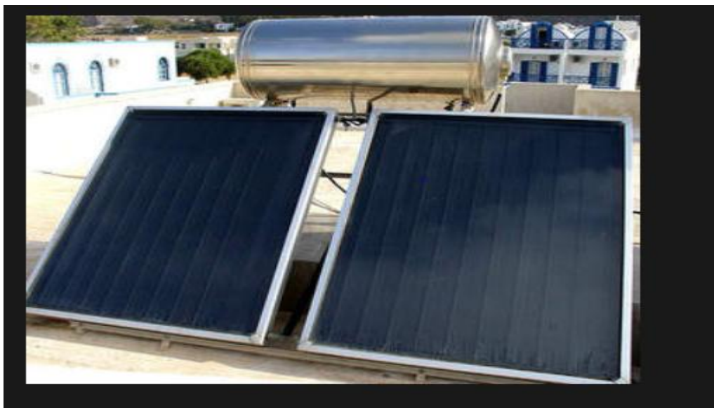
Figure 4-11 : panneau solaire thermique avec un ballon de stockage.[0]
