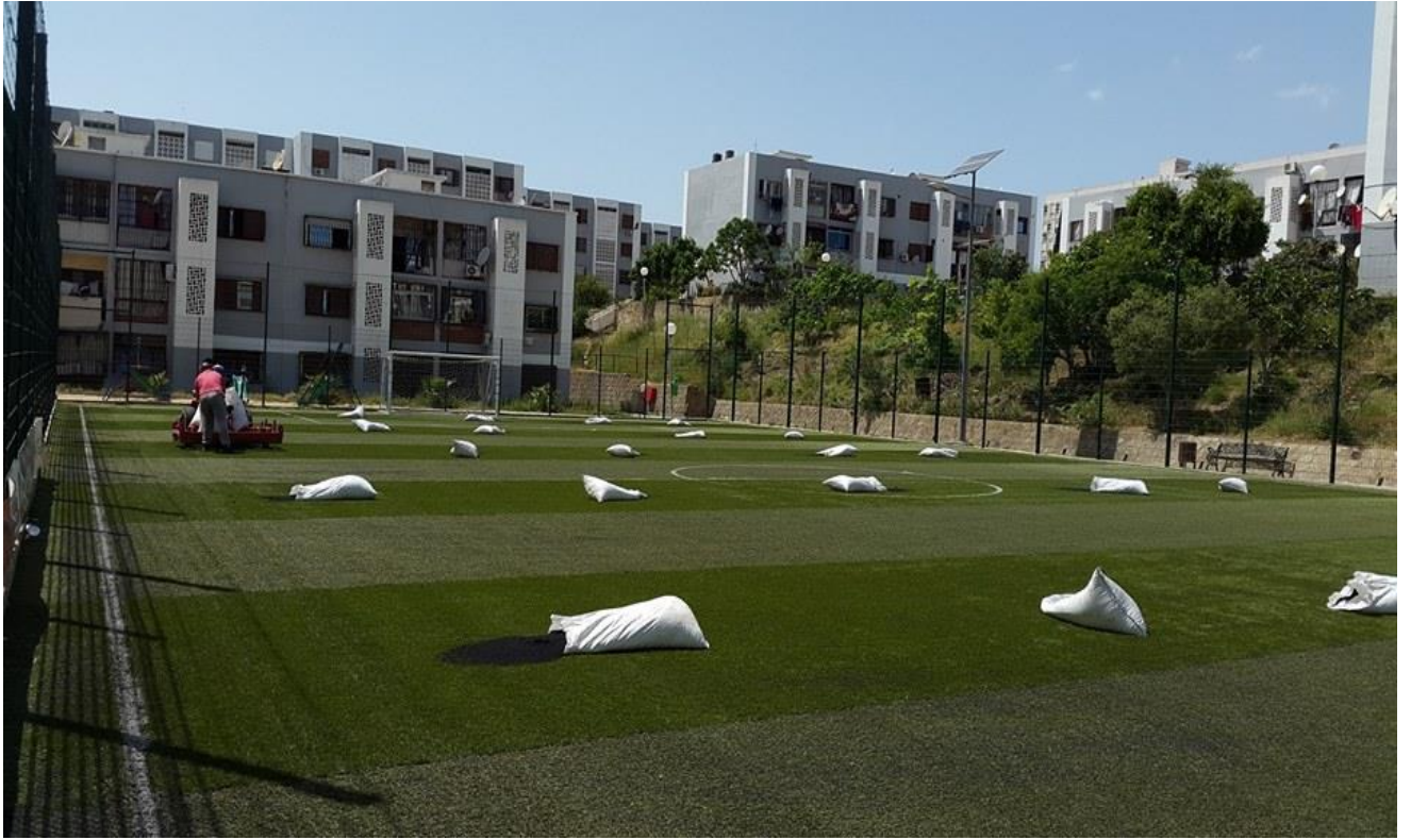
Figure 22: vue sur le stade après pose du gazon (source: facebook de l'association)
