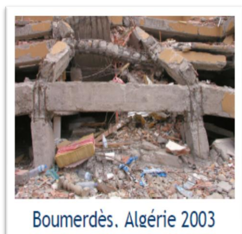
Figure (I.8) : absence de confinement du béton
