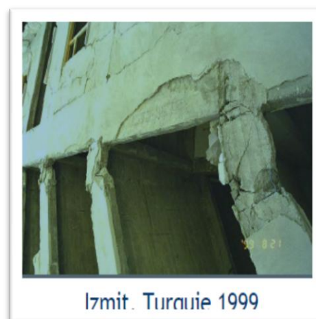
Figure (I.9) : manque de contreventement
