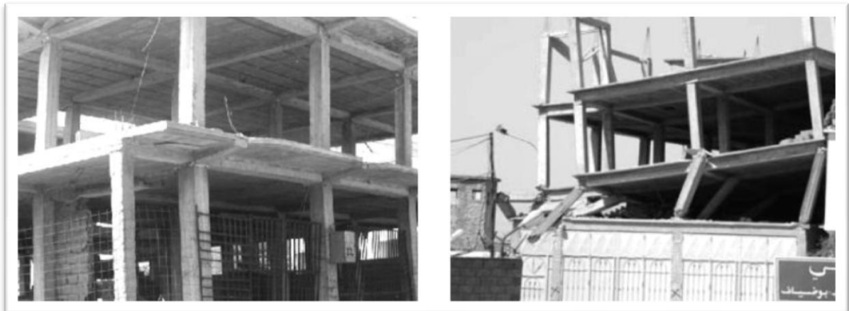
Figure (I.16) : dégâts occasionnés dans des structures auto stables en phase de réalisation.
