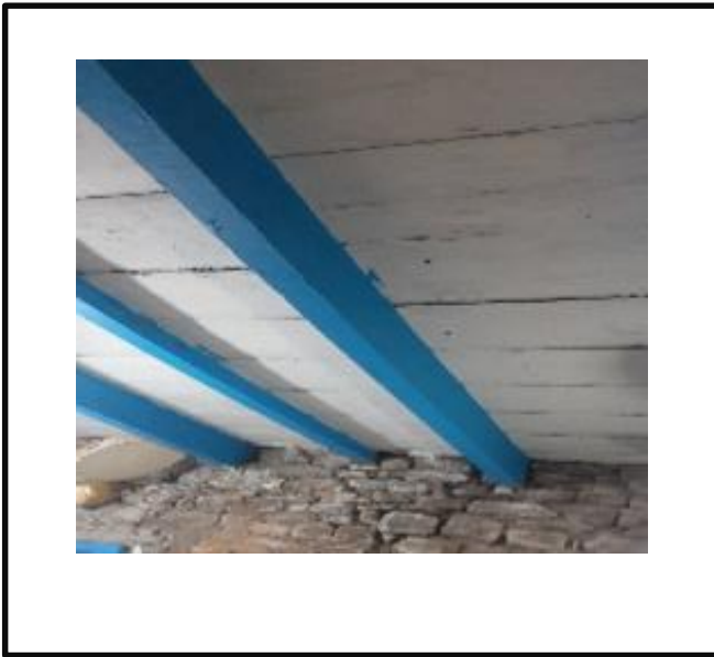
Plancher d'un atelier artisanal de la casbah Source : auteur le 03/11/2022
