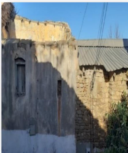
Photo 28: bâtisses présent des anomalies structurelles Source : auteur le 03/11/2022
