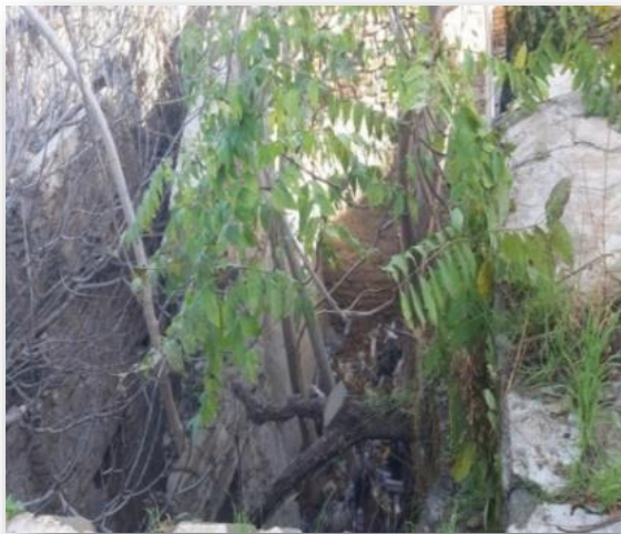
Photo 27: bâtisse totalement effondrée Source : auteur le 03/11/2022
