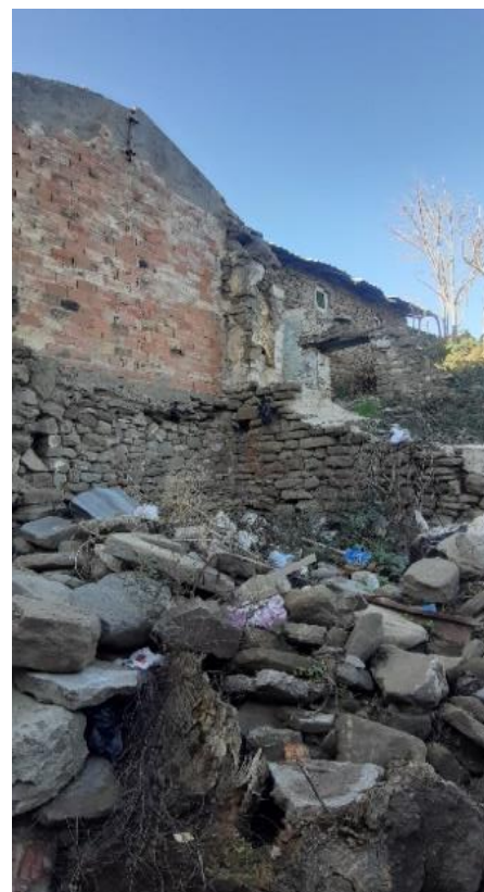
Photo 29: bâtisses partiellement effondrée Source : auteur le 03/11/2022
