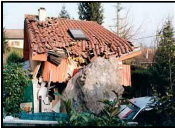
Figure I.1-10 : Chute de bloc sur une maison à Lumbin (Isère).janvier2002
