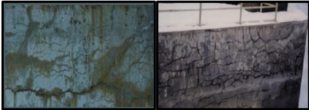
Figure I.1-6 : Exemples de dégradations d'ouvrages dues à l'alcali-réaction
