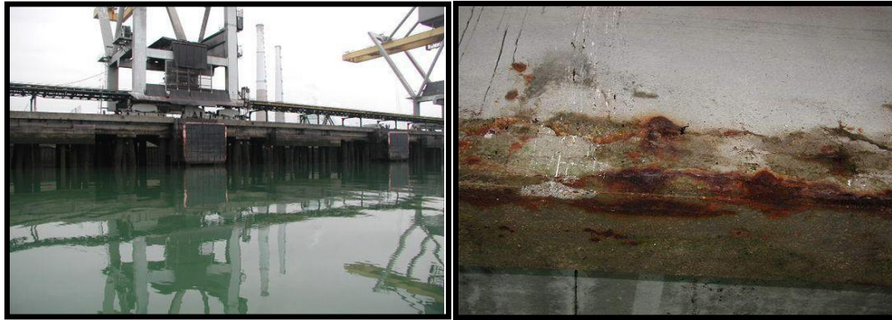
Figure I.1-5 : Poutres i tuée en bord de mer sous de l'agression des chlorures
