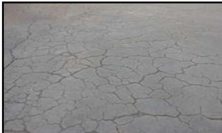
Figure I.1-7. Fissuration de peau du béton
