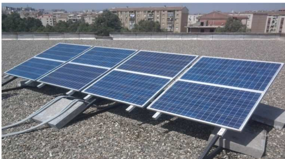
Figure III.1. Modules PV installés sur le toit du laboratoire LATAGE
