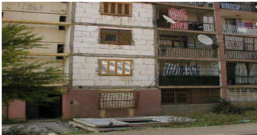
Figure II.4: Décollement de l'enrobage [12].
