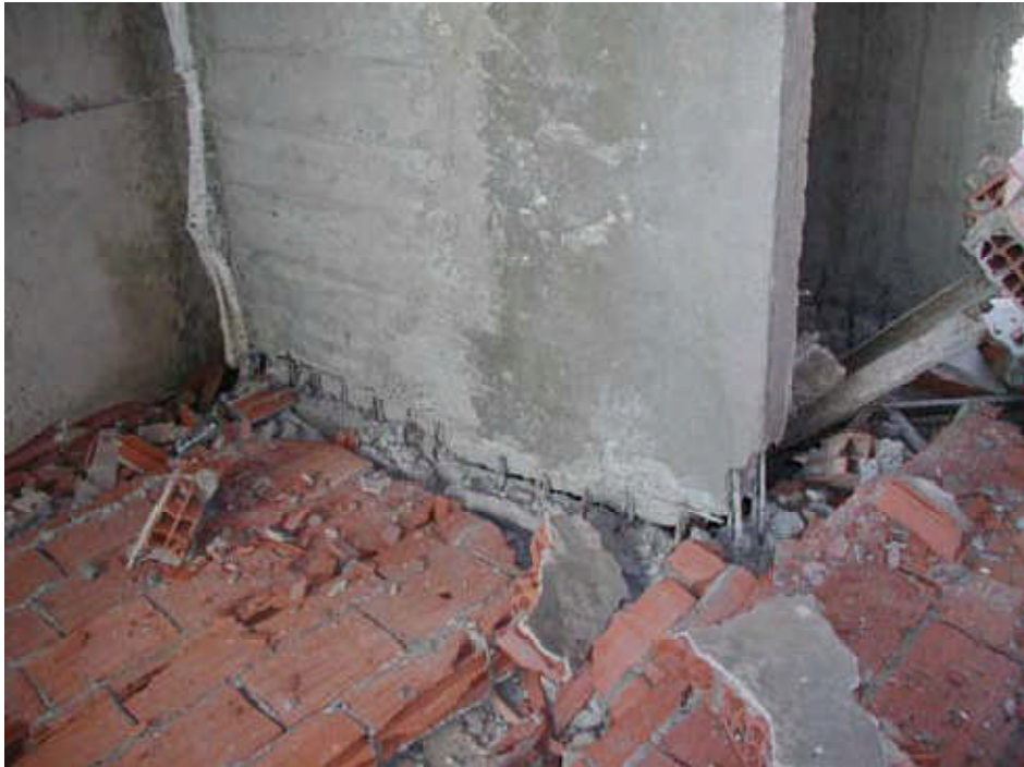
Figure II.5: Rupture de section à la base du voile [13].
