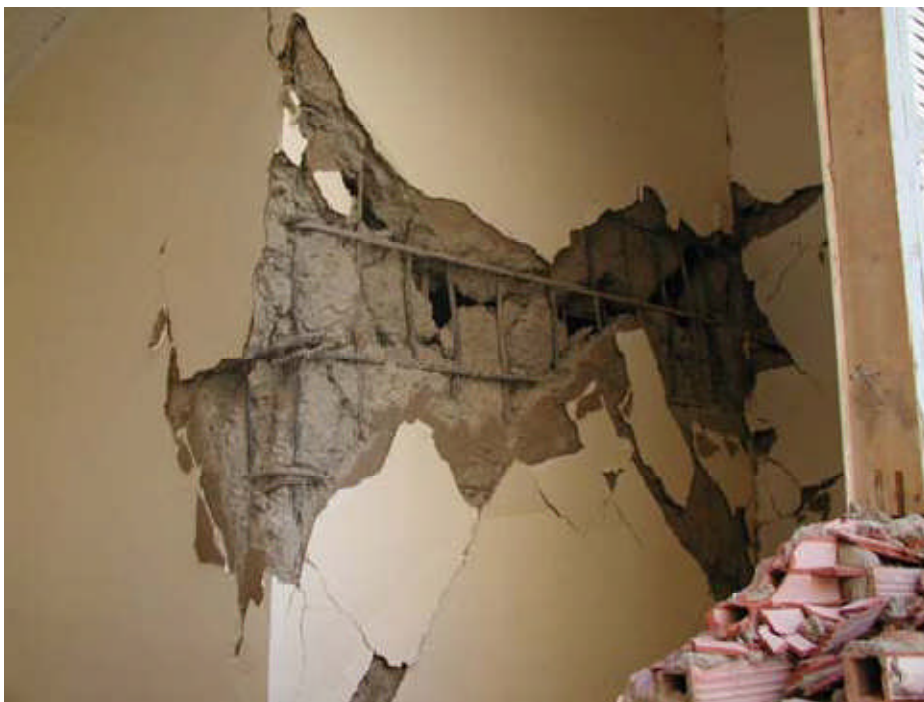
Figure II.6: Fissures ouvertes dans le voile [13].
