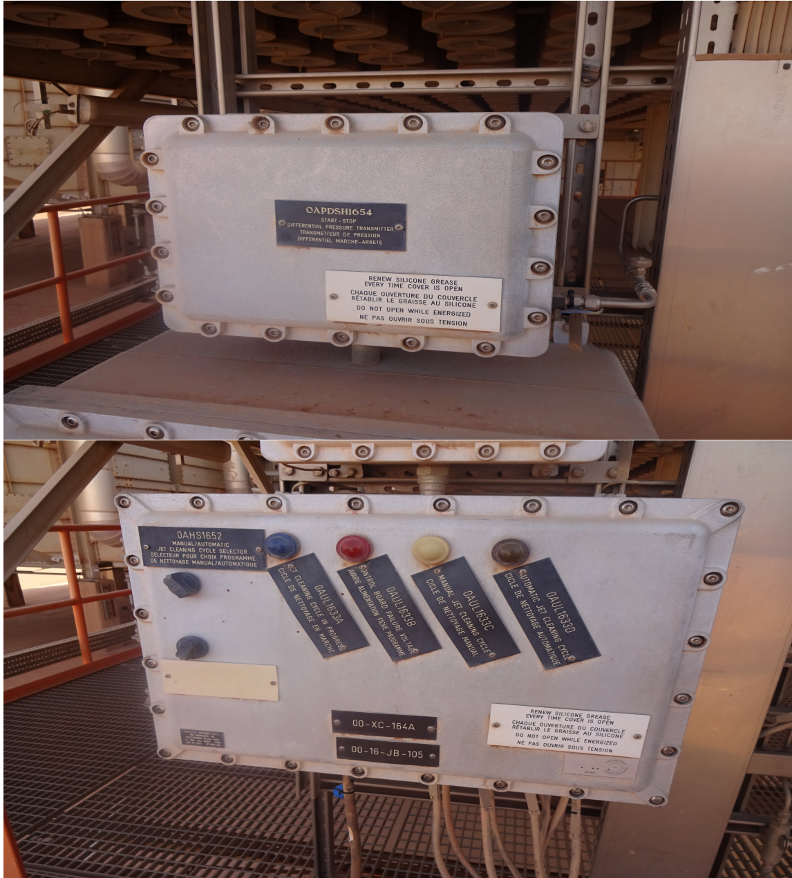
FIGURE 3.8 – Vue réelle des deux coffrets.
