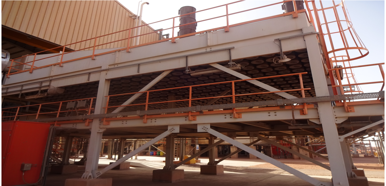
FIGURE 3.2 – Vue réel sur site IA du système de filtration.
