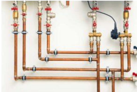
Figure (III-30) : tuyaux en cuivre [47].
