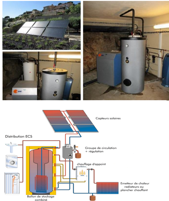
Figure (II-3): Chauffe-eau solaire CEST [28]
