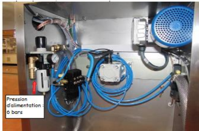
Figure 1.16: Photo réelle des distributeurs et alimentation pneumatique.
