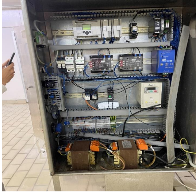
Figure 1.13 : Photo réelle de l'armoire électrique.
