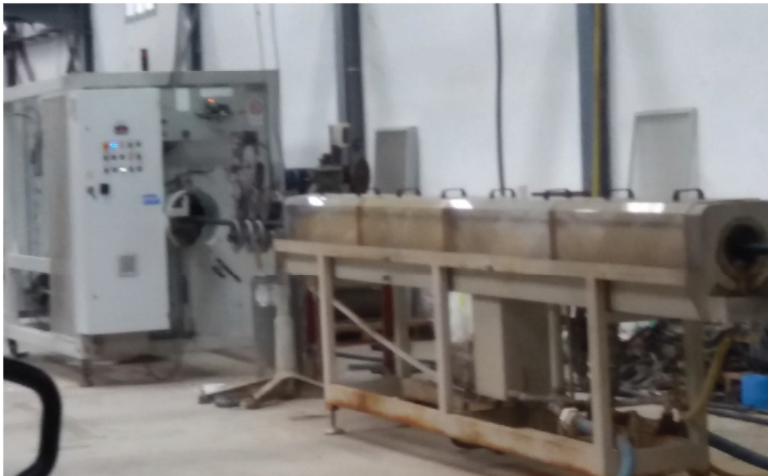
Figure 4 : bain de refroidissement
