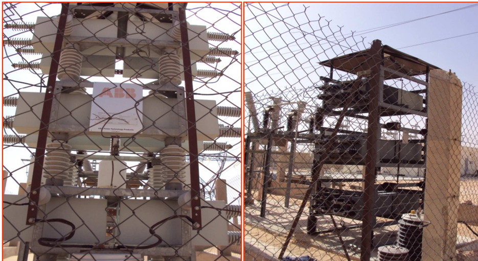
Figure I.8 : Les batteries de condensateurs.
