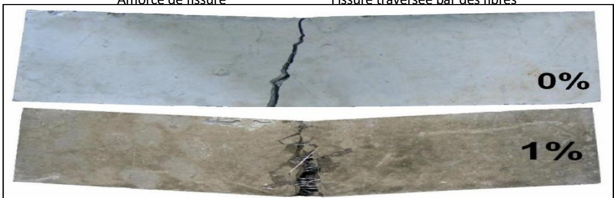
Figure.II.6 : le contrôle de la propagation d'une fissure [36]
