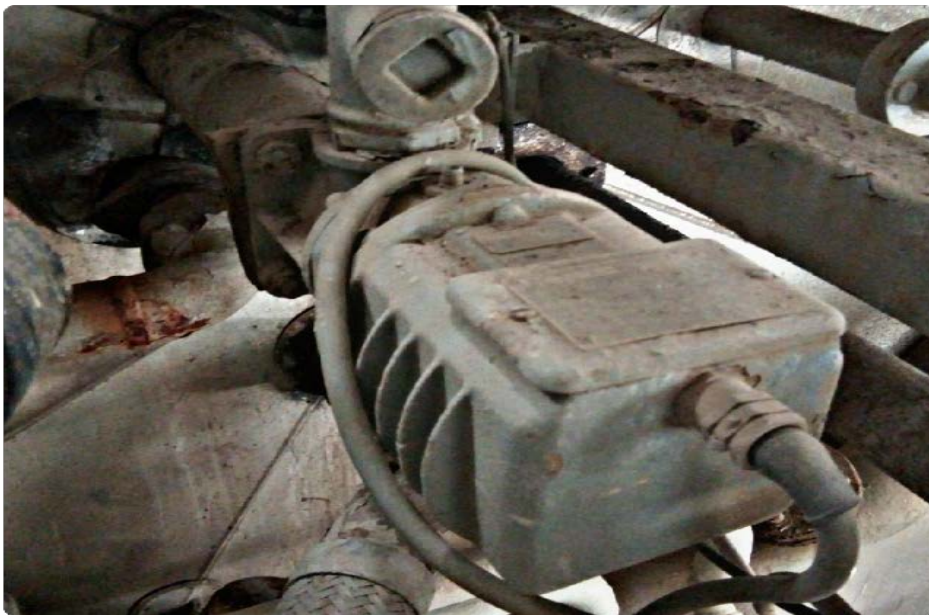
Figure II.4 : Photo d'un brûleur d'allumage (CAP-DJINET)
