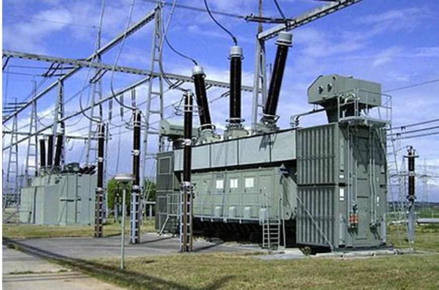
Figure II.1 : Un transformateur de puissance dans un poste électrique.
