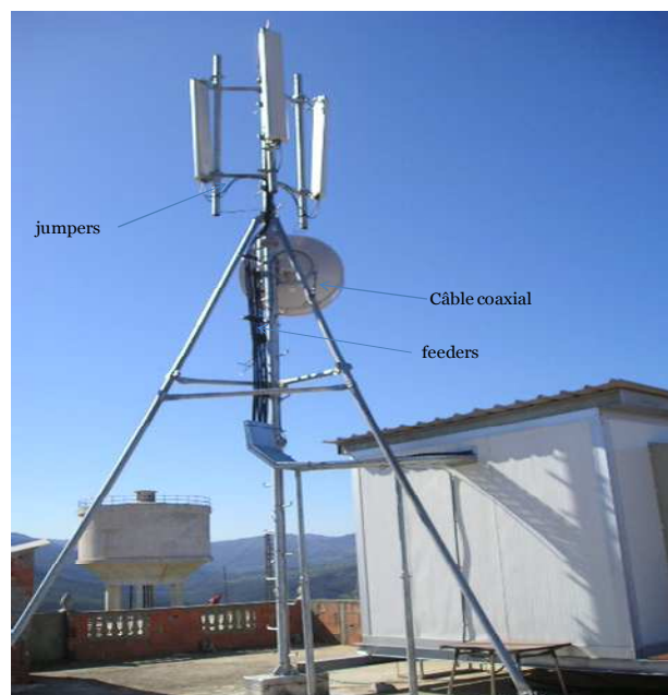
Fig. IV.1. Vue d'ensemble d'une station de base.
