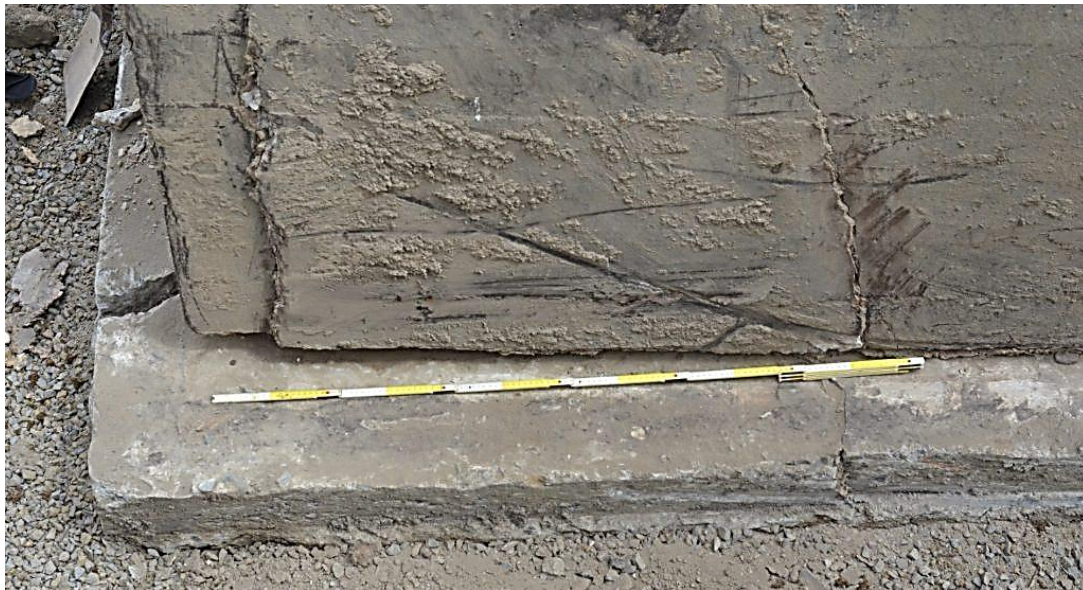
Figure.V.7. Affaissement et fissure de la fondation(BEBEXPERTS, 25 mars 2019).
