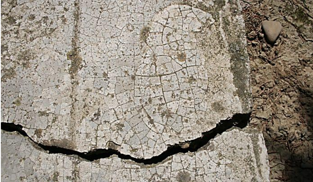
Figure.V.6. Affaissement de la fondation et dallage(GEOSEC, 2018)
