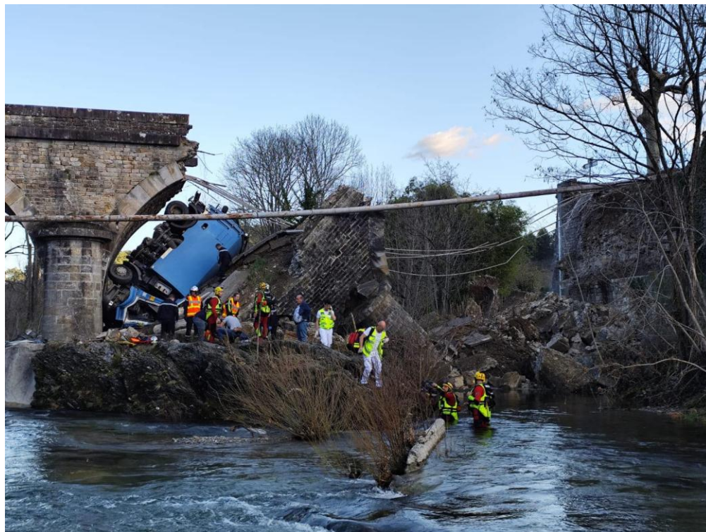
Figure.V.11. le pont de Chamborigaud s'est effondré le 18 mars 2024(Casez, 2024)
