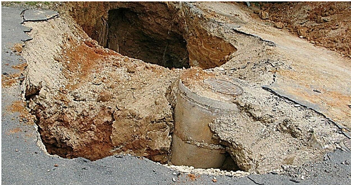
Figure. V.8. Une route affaissée en Mayenne (FRANCE, 25 janvier 2021).
