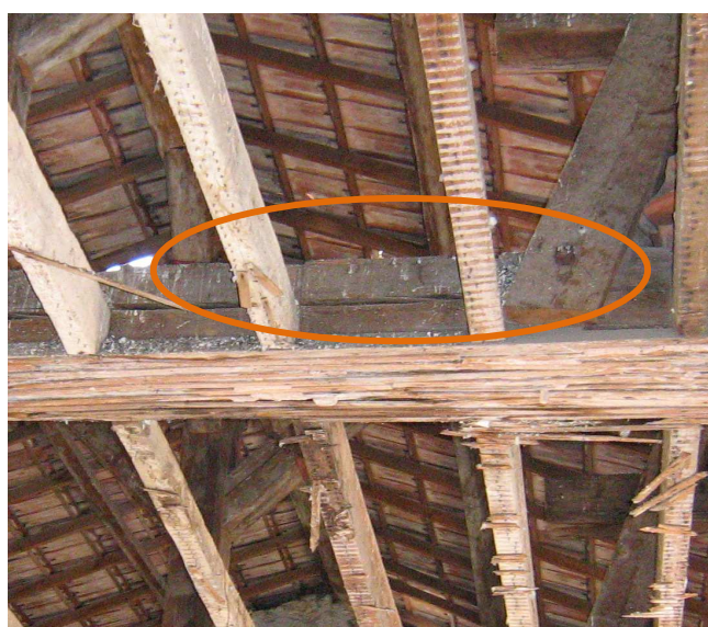
Photo 3.3. Fissure au niveau de l'assemblage.
