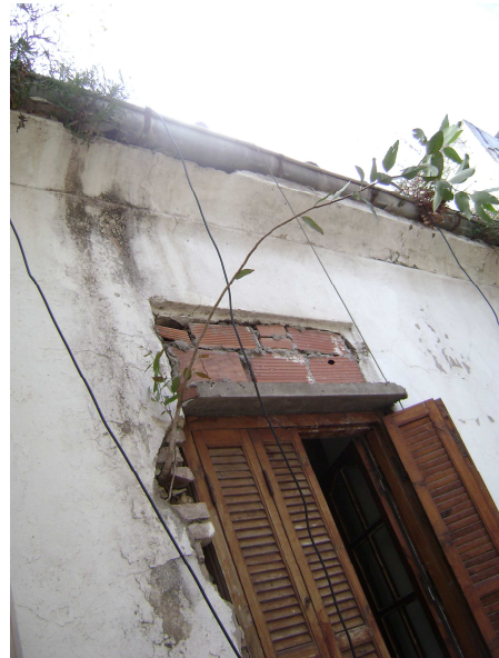
Photo 3.14. Entartrement des évacuations d'eau pluviale
