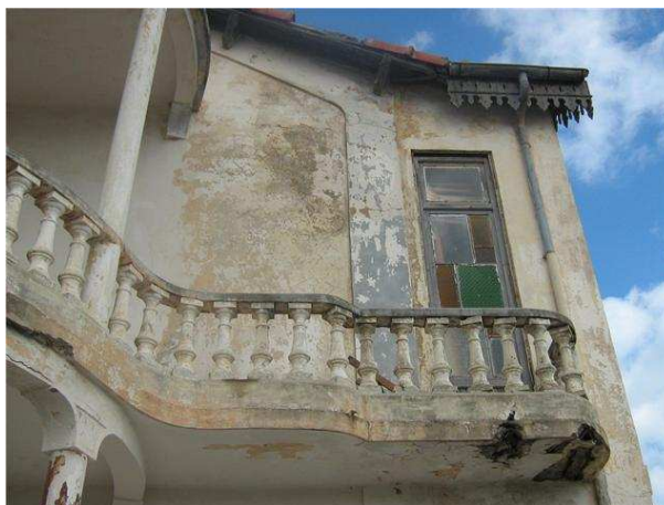
Photo 3.13. Encrassement des façades.
