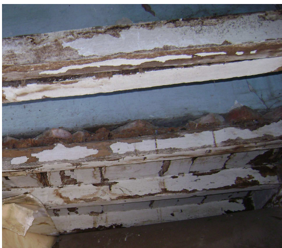
Photo 3.2. Fluage des poutres dues au poids du plancher.
