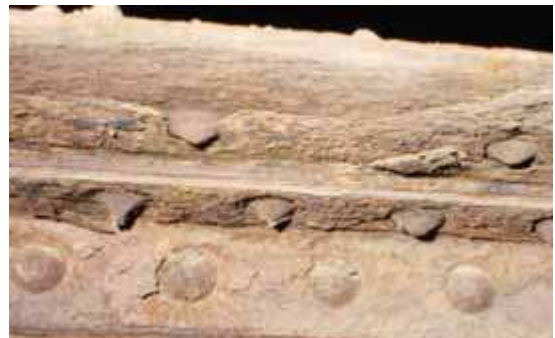
Photo 3.12. Corrosion de rivet.
