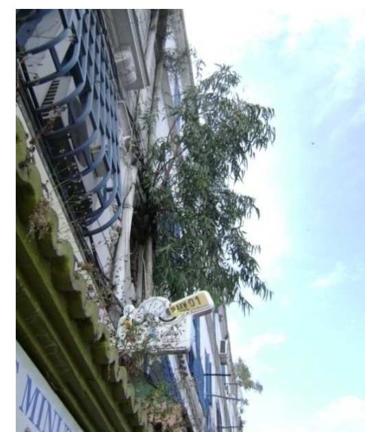
Photo 3.5. Prolifération de végétation engendrant la fragilisation des murs.
