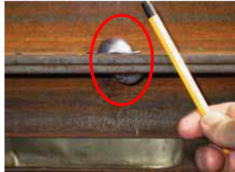
Photo 3.14. Défaut de pose de rivet.
