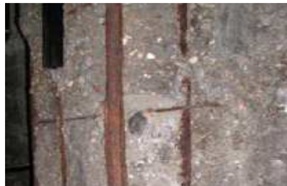
Photo 3.9. Corrosion des armatures.
