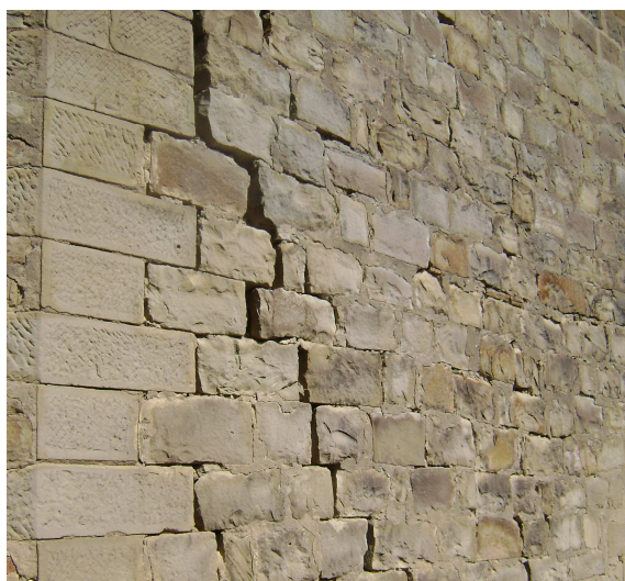
Photo 3.7. Fissuration due au droit des angles.
