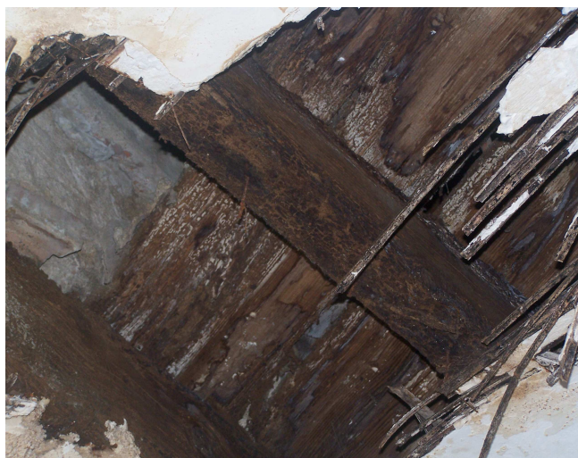
Photo 3.1. Présence de moisissures à la surface de la poutre en bois
