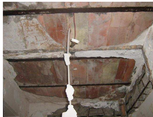
Figure 5 : Décollement de l'enduit plâtre.
