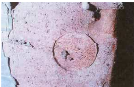
Photo 3.13. Rupture de rivet.
