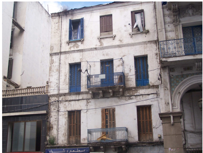
Photo 3.12. Dégradation des évacuations d'eau pluviale.
