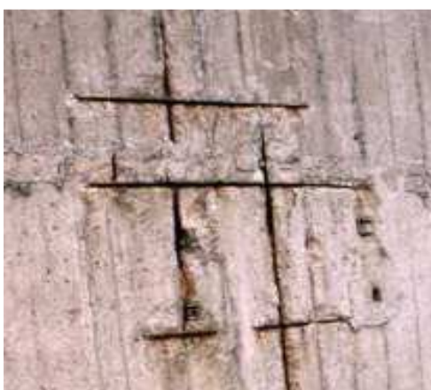
Photo 3.10. Non respect de la couche protectrice des armatures.
