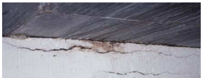
Photo 3.8. Action du chlore sur le béton armé
