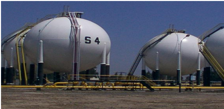
Figure 1. 3: Sphère de stockage des GAZ Raffinerie Liquide « propane et butane »
