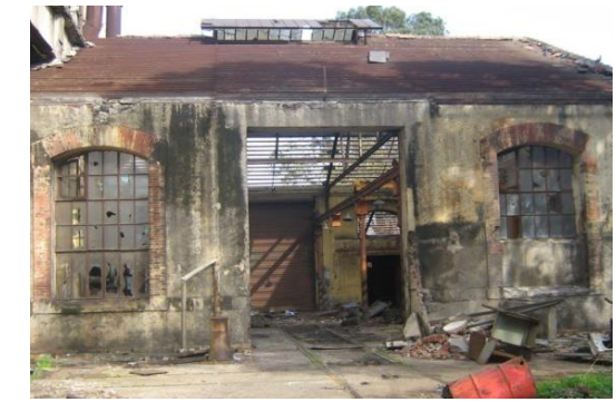
Le magasin aux métaux précieux en très mauvais état
