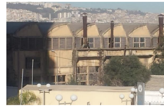
Atelier de maintenance en très mauvais état
