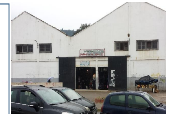
Hangar fermé en mauvais état actuellement reconvertis en marché
