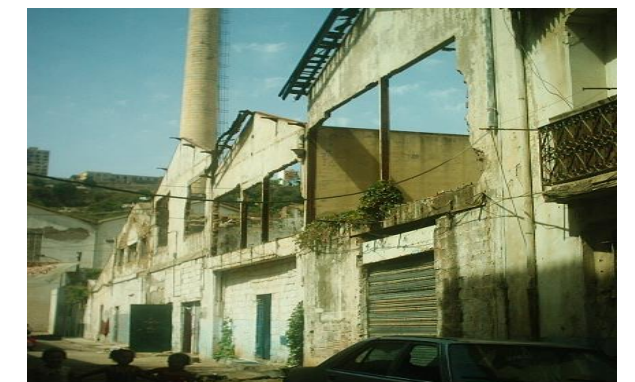
Bâti en très mauvais état
