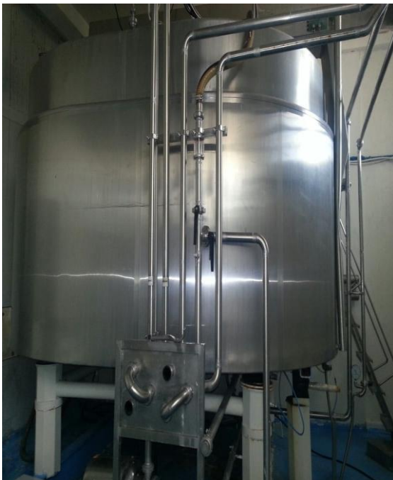
Figure N°05: tank de préparation
