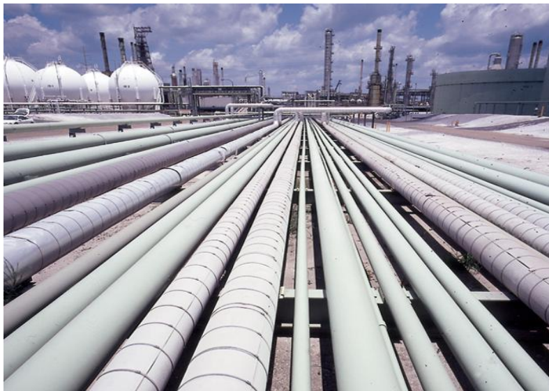
Figure I.1 : Canalisation de transport de produits
