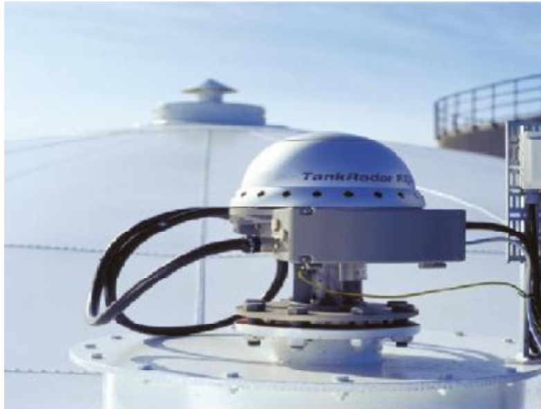
Figure III.9. Raccordements électriques du RTG 3900 REX.
