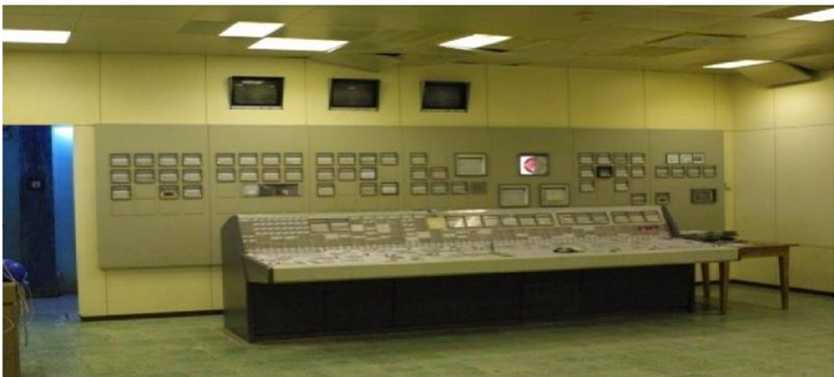
Figure I.7 : la salle de commande centralisée
