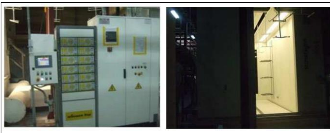
Figure II.4 : La cabine de poudrage utilisée
