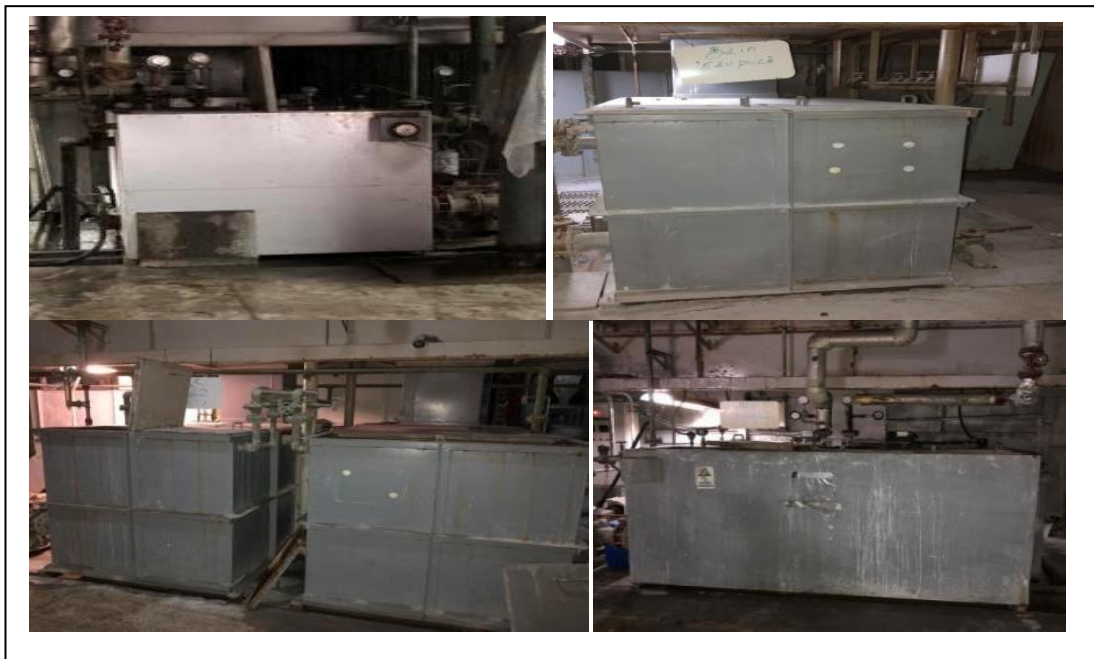
Figure II.2 : Le tunnel de prétraitement.
