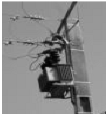
Figure -I- 3 : Transformateur
