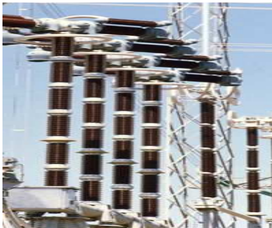
Fig.II.8 : Disjoncteur à air comprimé
