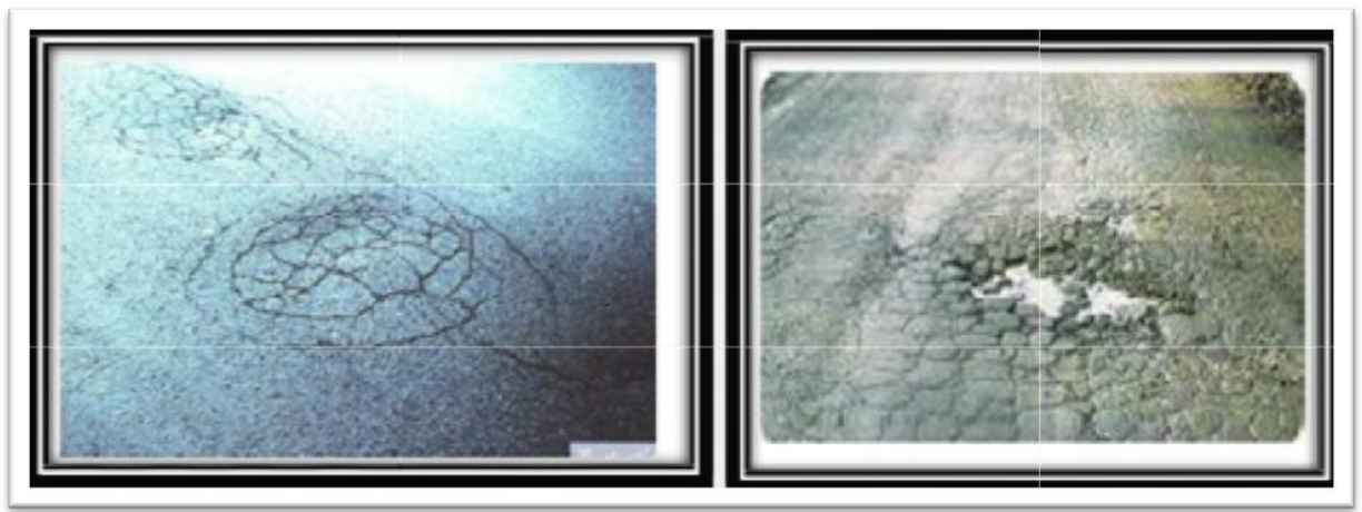
Figure II.3 : Dégradation des routes [15].
