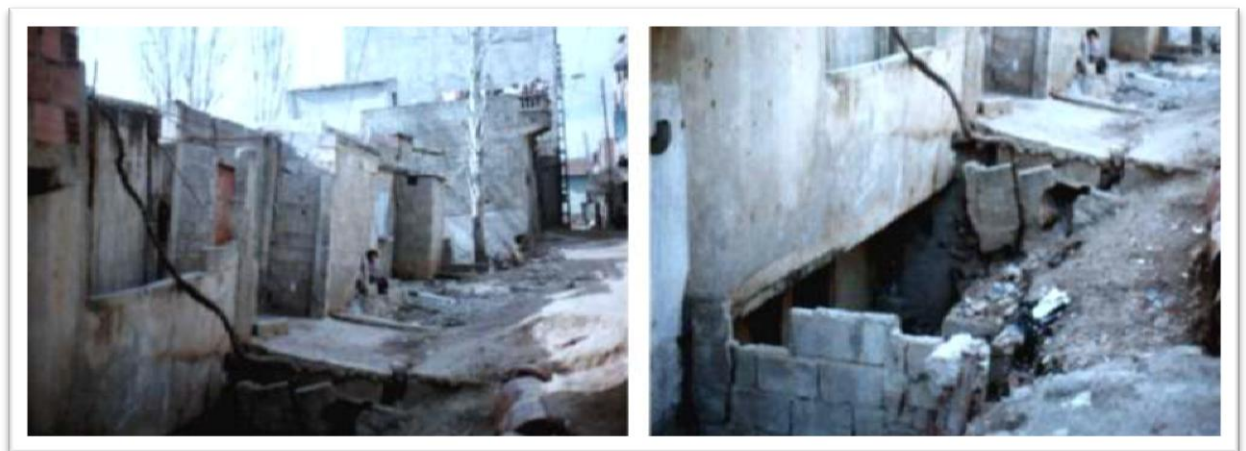
Figure II.2 : Vue partielle d'un alignement de constructions ayant subi des basculements à Boudraa Salah [14].
