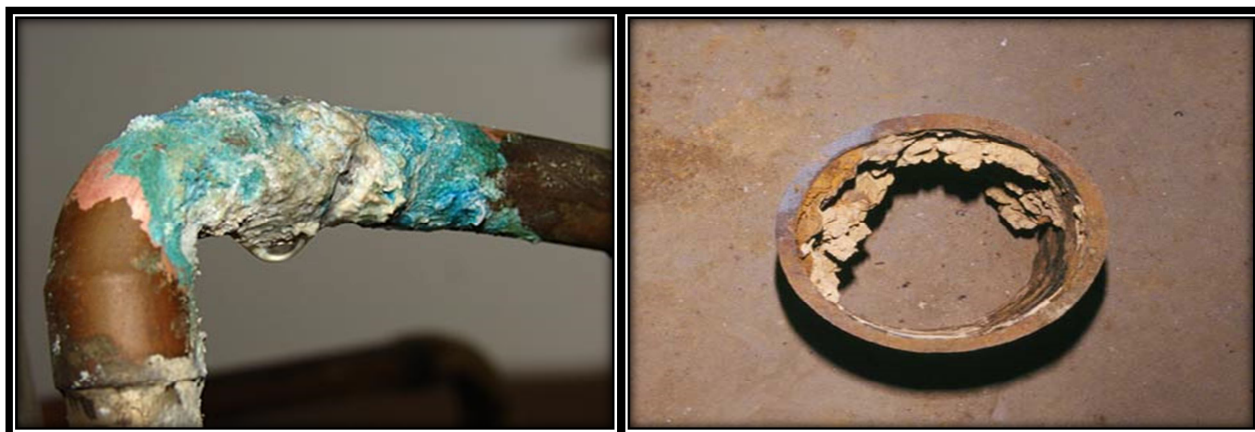
Figure VI-14) : la corrosion des conduites
