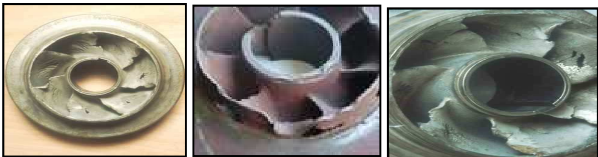
Figure VIII.8) : Photos illustrant le phénomène de cavitation sur des aubes de pompe centrifuge
