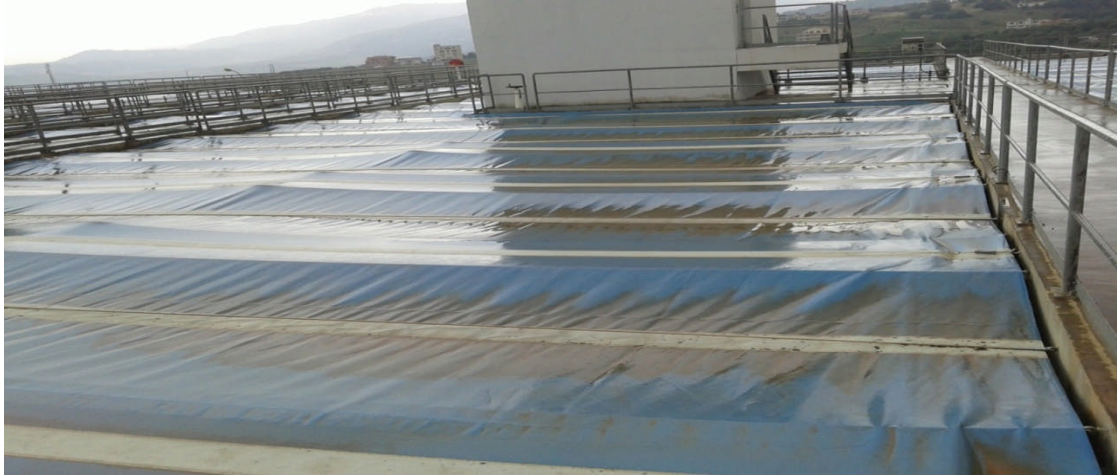
Figure 14: Décanteurs (Pulsa tube)
