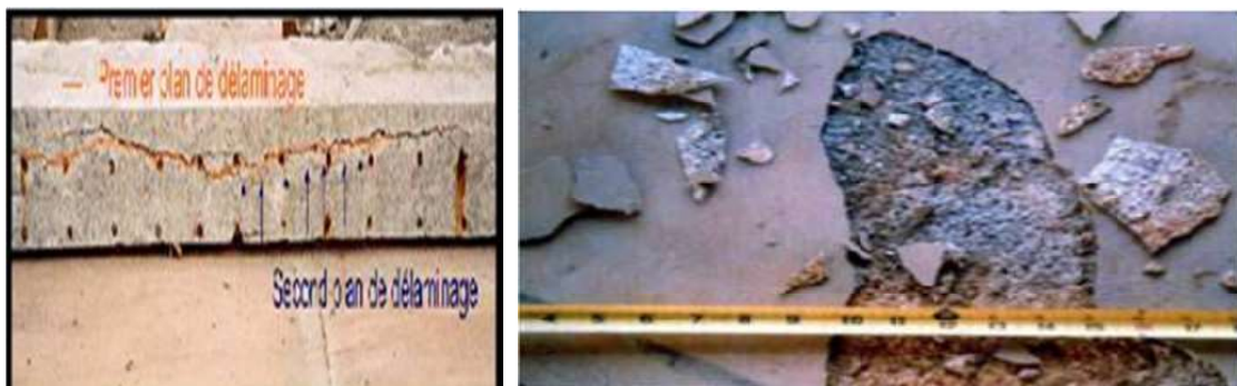
Figure I.10 : Délamination du béton
