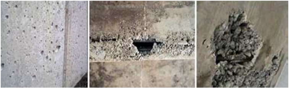
Figure I.12 : Défauts dû au mal exécution des travaux
