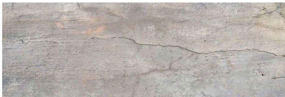
Figure I.4 : Effet du Ressuage du béton
