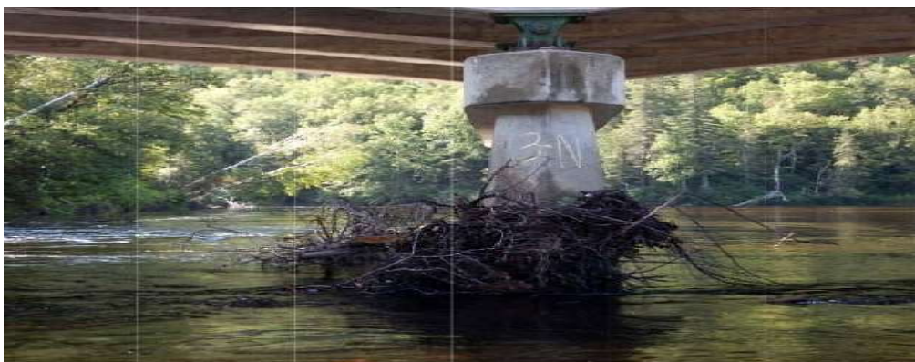
Figure I.2 : Abrasion visible sur les fondations du pont
