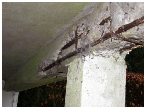
Corrosion des armatures dans les structures en béton armé
