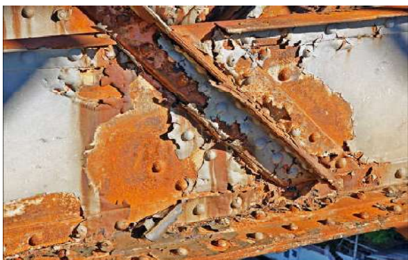
Corrosion atmosphérique des ouvrages métalliques
