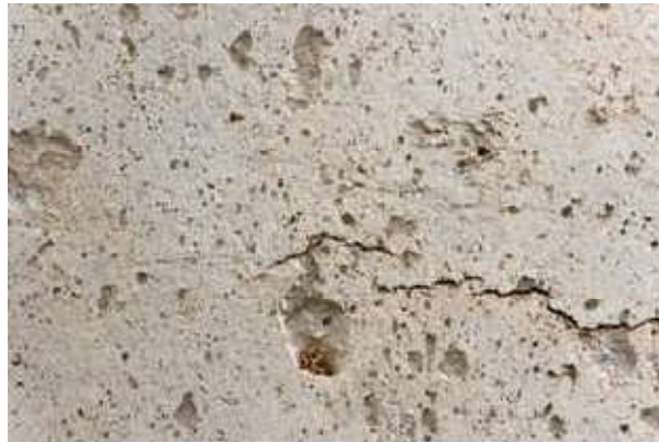
Figure I.9 : Ecaillage du béton
