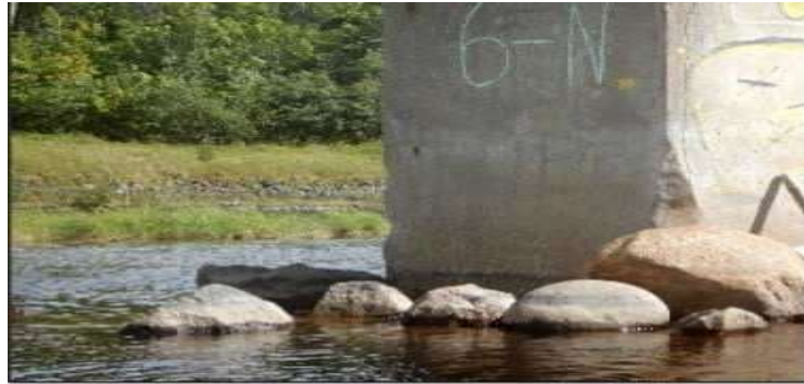
Figure I.3 : Fissures polygonales et zones d'érosion par abrasion
